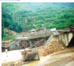
สิ่งก่อสร้างกีดขวางทางน้ำ
